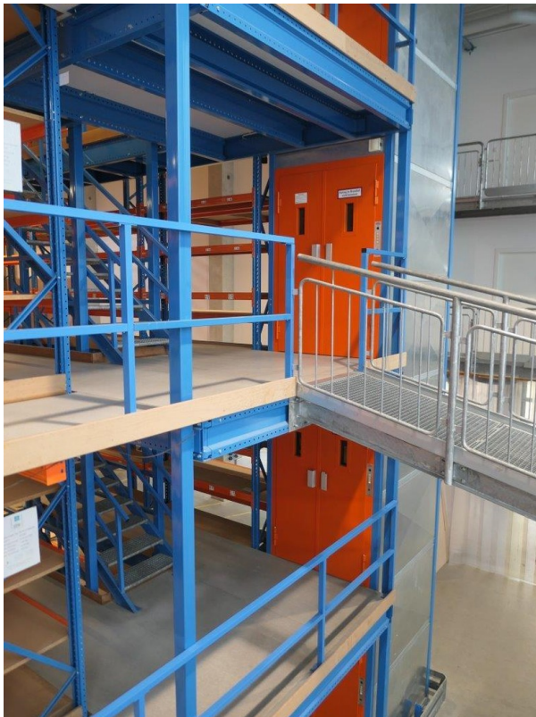
Lastenaufzug im Picklager
