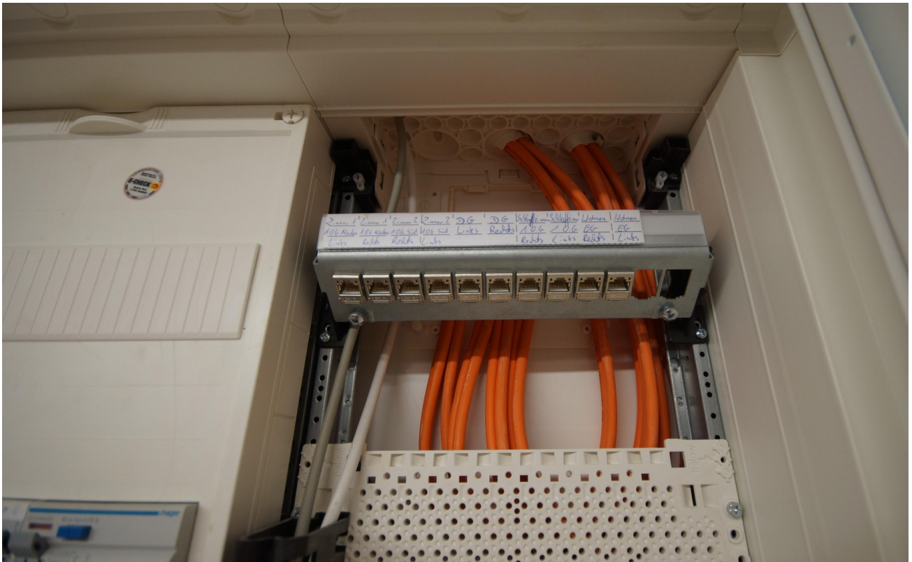
Technikraum Keller LAN
