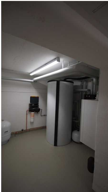
Technikraum Keller Heizung
