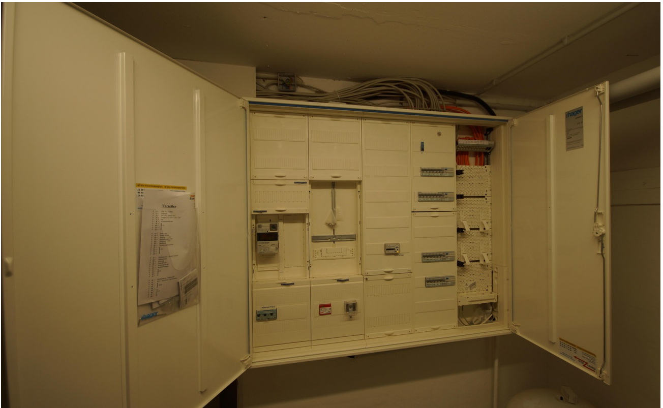
Technikraum Keller Strom
