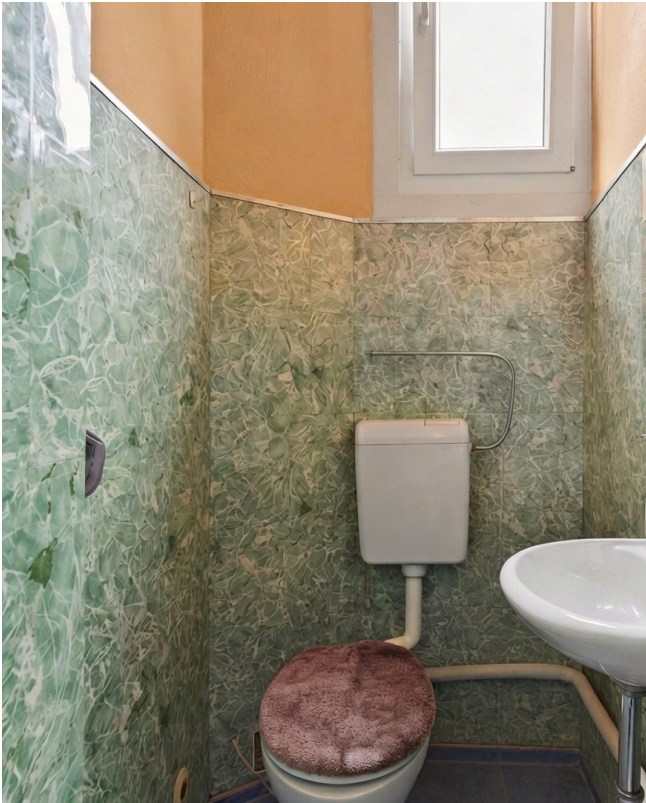
1.OG WC / im Treppenhaus!
