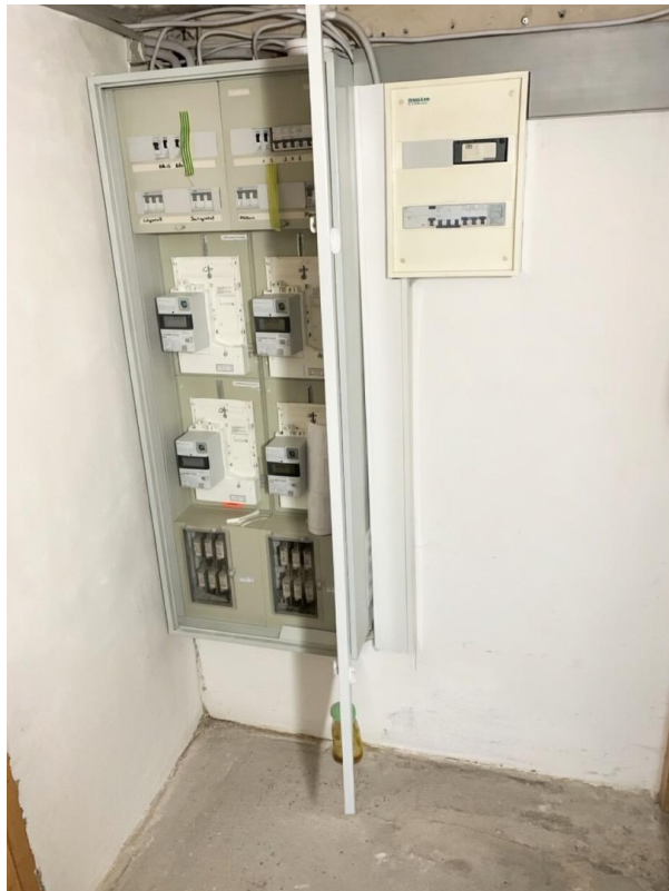
KG Zählerschrank 4 Zähler
