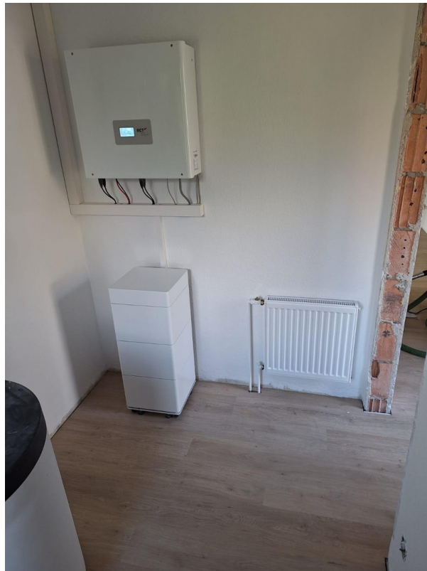
Neuste Technik - PV Anlage
