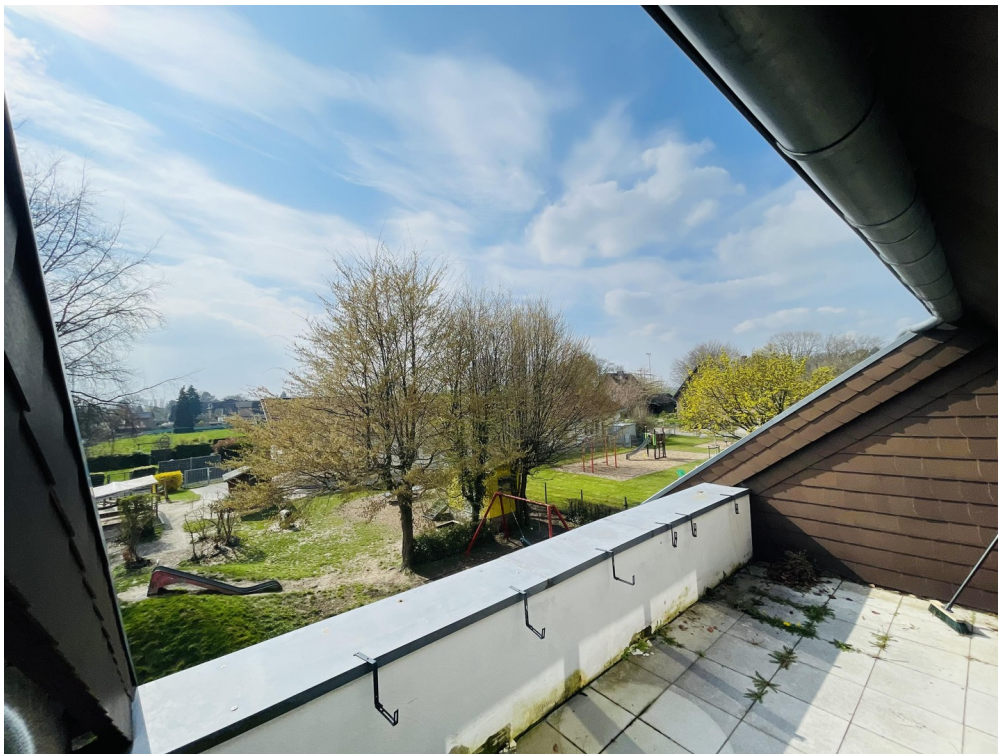
Balkon Foto unrenoviert
