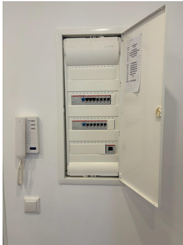
Sicherungskasten (neue Elekt.)
