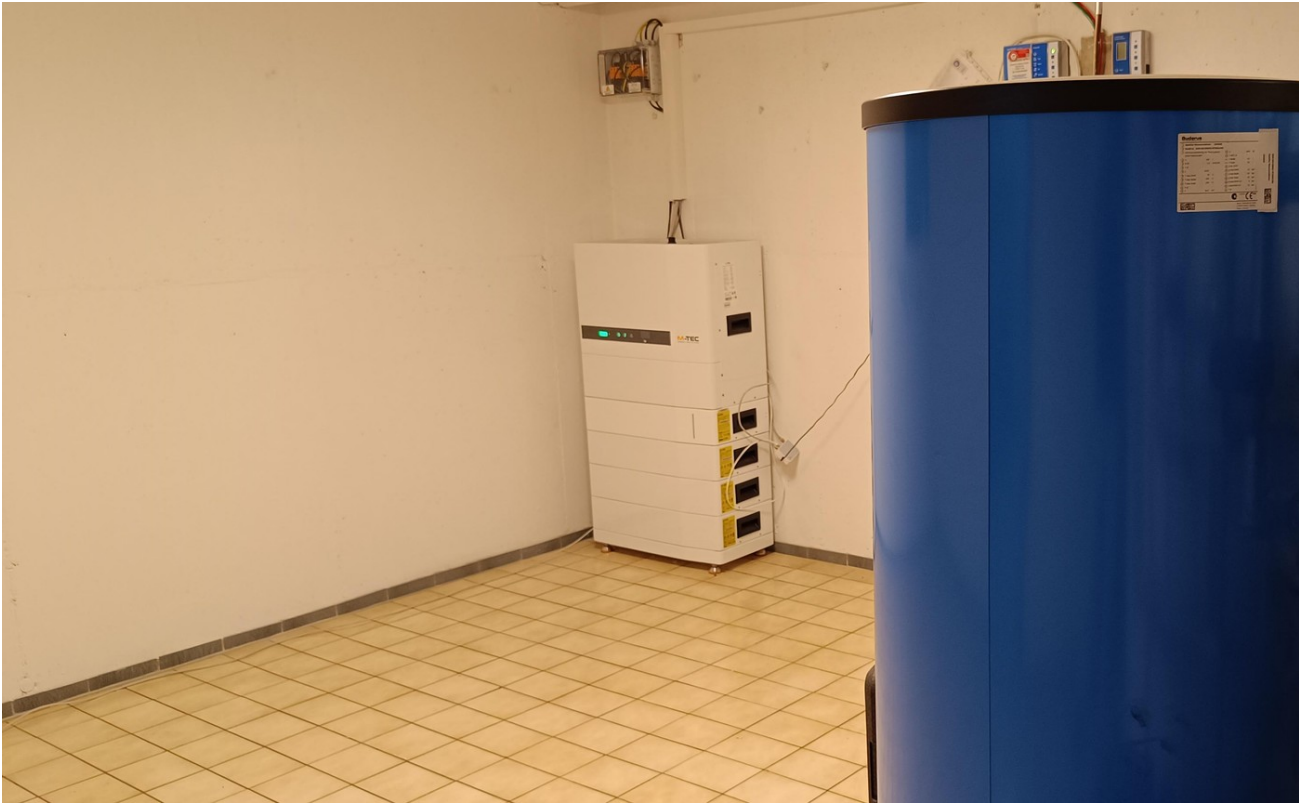
heizraum mit Solarspeicher
