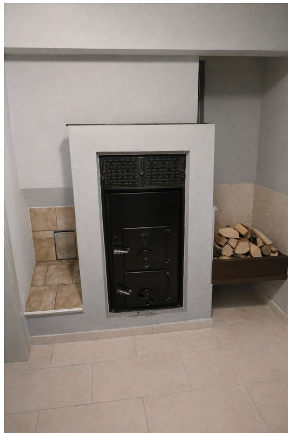
Befuerung Kachelofen Keller
