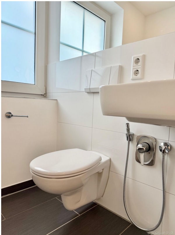
mit Dusch-WC u. Außenfenster
