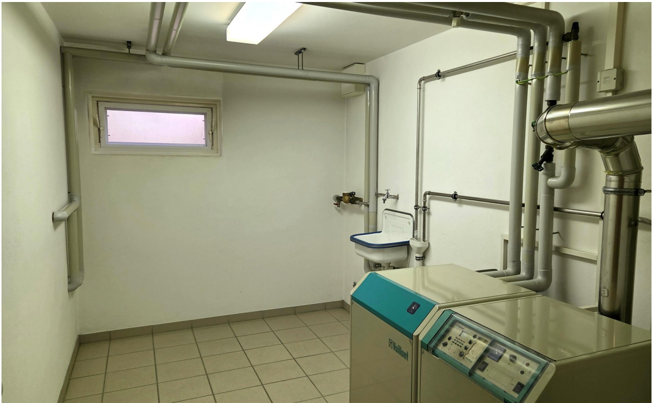
Heizungsraum im KG
