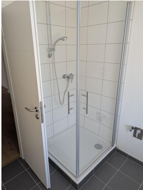
Bad Bild 2 DUSCHE
