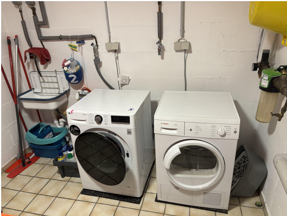
Waschküche inkl. Fernwärme
