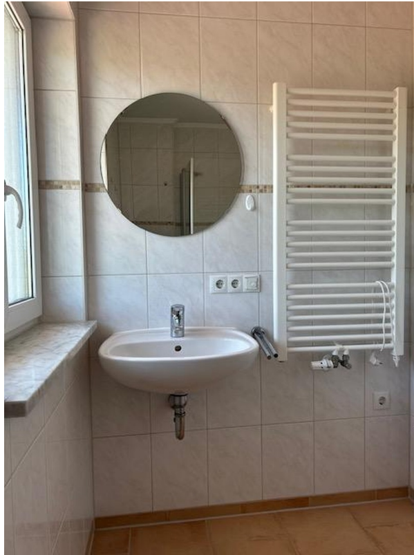
OG. 1 Bad Fenster Ostseite
