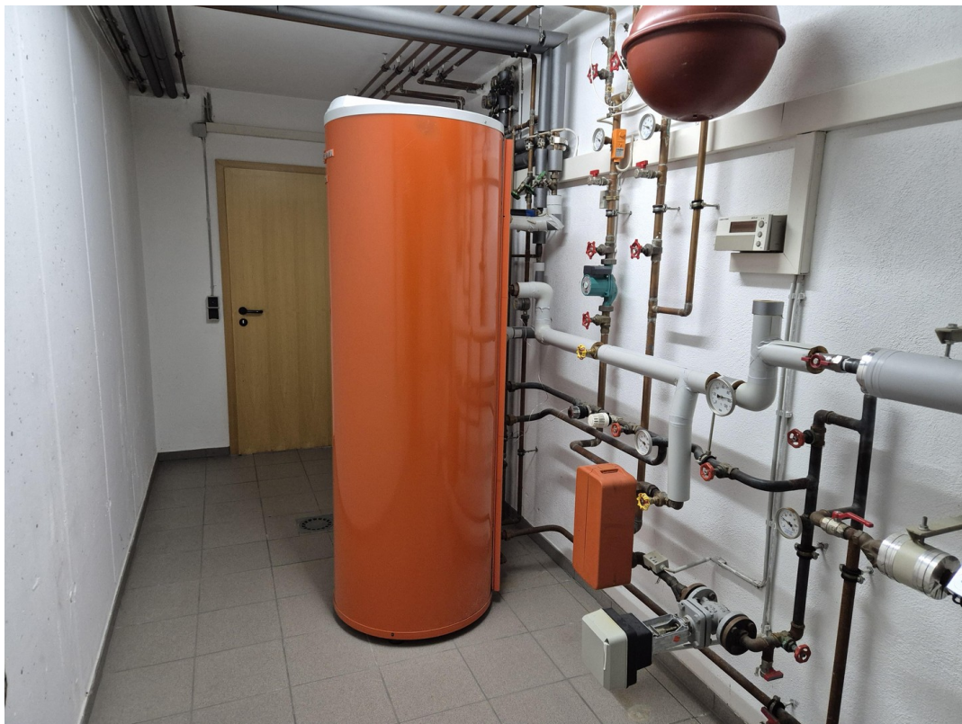
18_Fernheizung im UG
