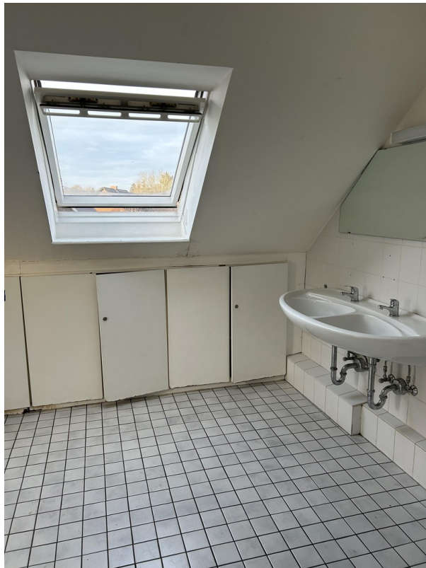
Bad DG Hauptgebäude A
