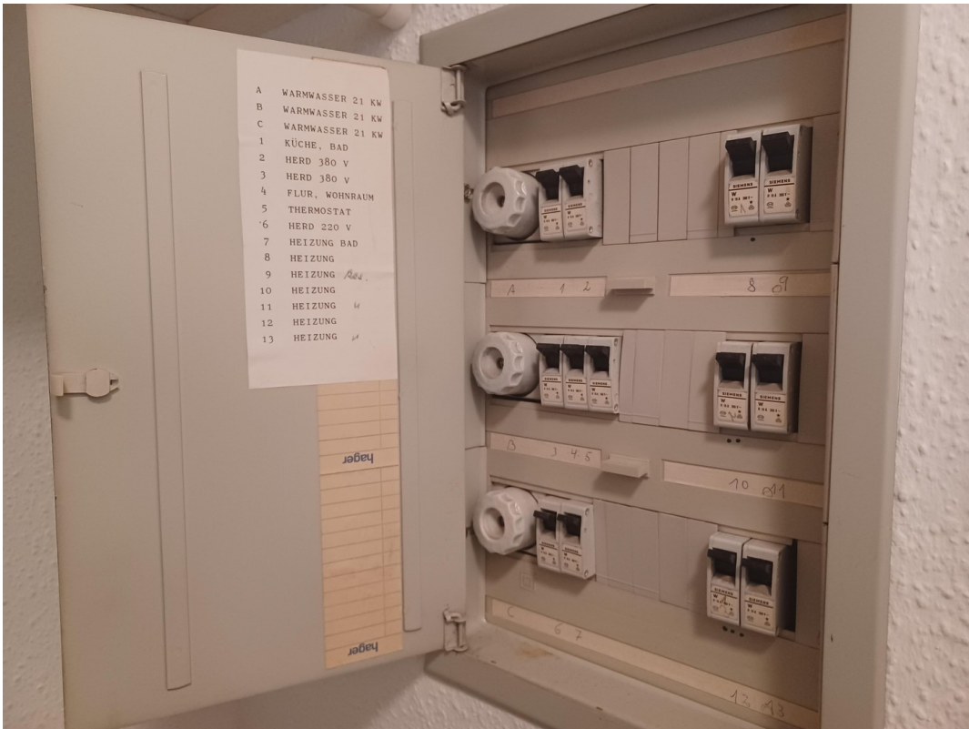
Sicherungskasten im Flur
