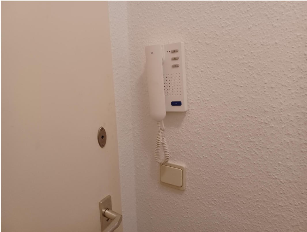
Sprechanlage im Eingang
