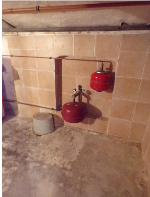
Kellerraum II AusgleichsgefäÙe
