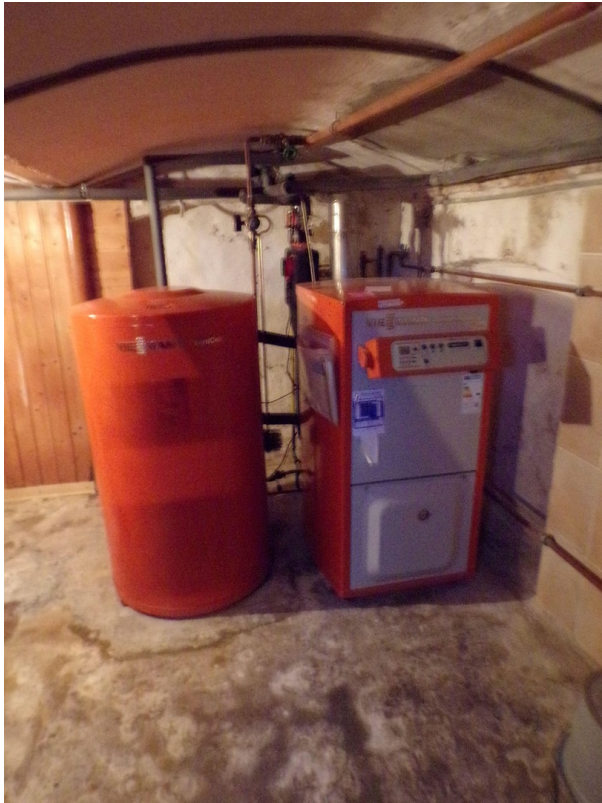
Kellerraum II Heizungsanlage
