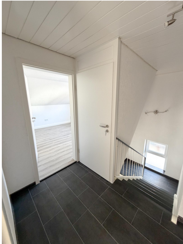
Flur OG mit Klimaschutztür
