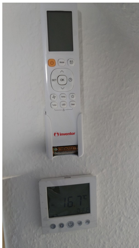
Klima und Fußbodenheizung
