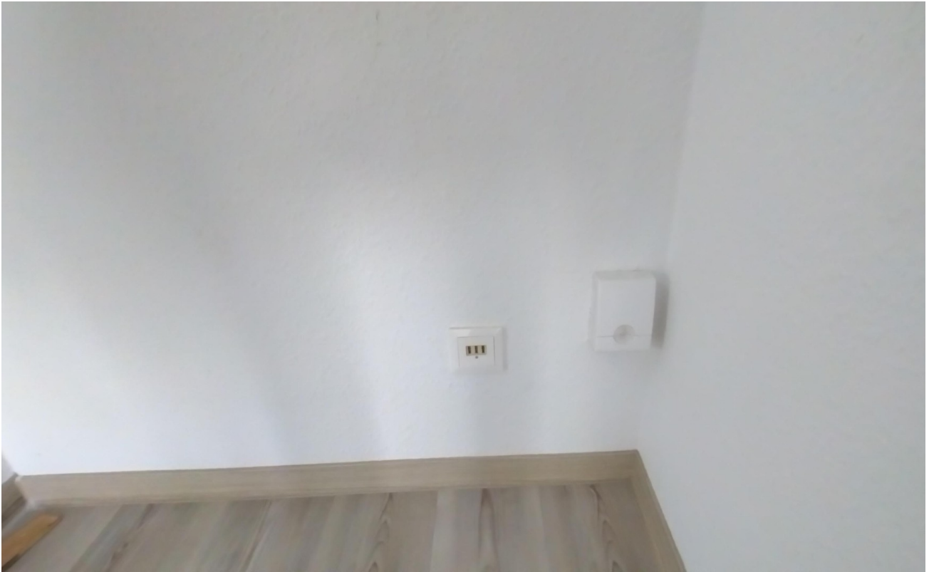
Glasfaser und Telefon
