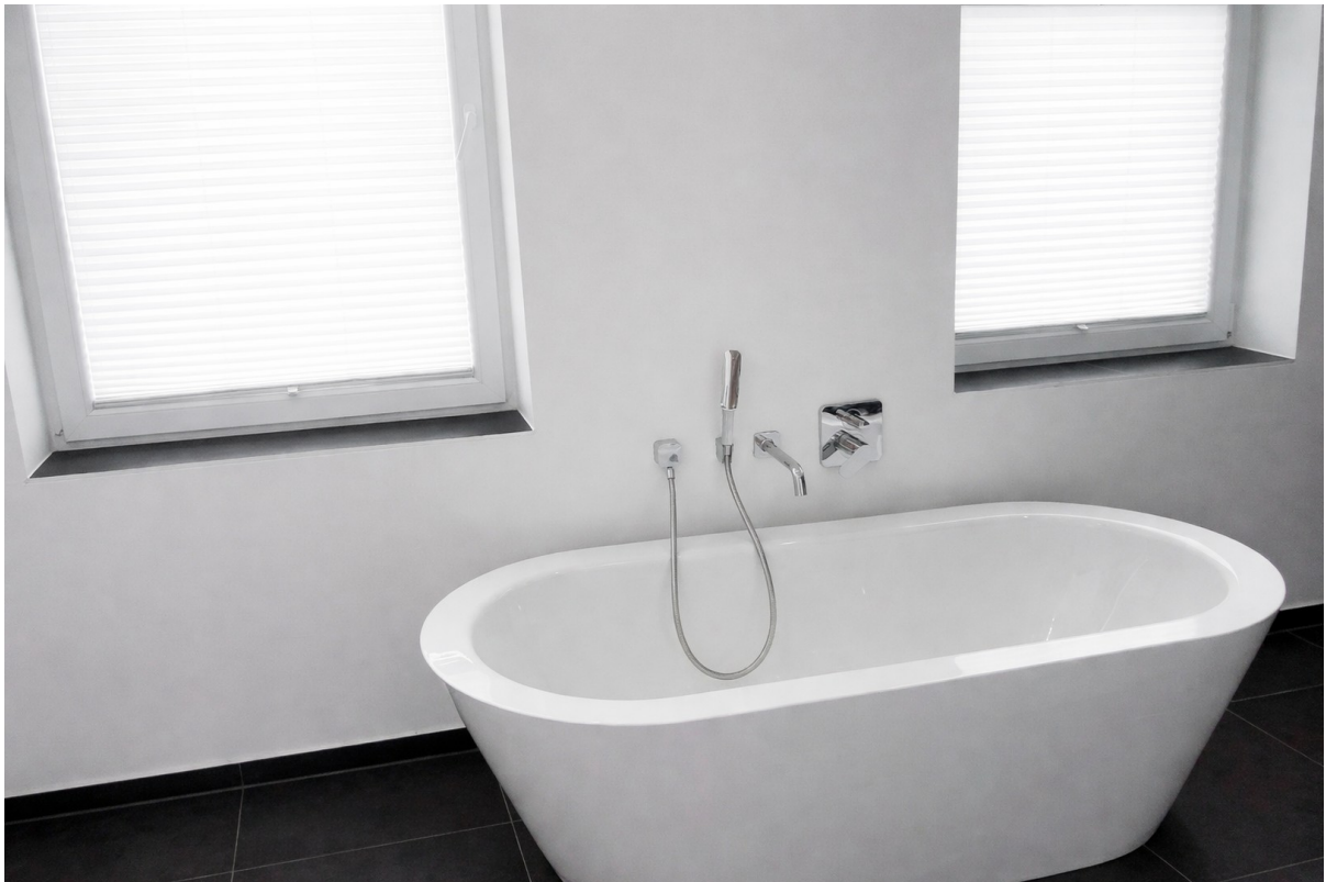
freistehende Badewanne 3. OG
