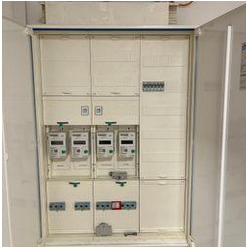
2021 wurde die Hauptverteilung
