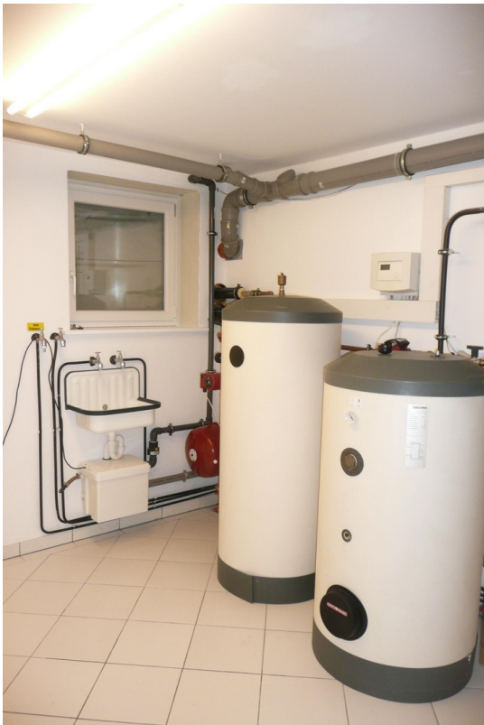
Energiezentrale der Wärmepumpe
