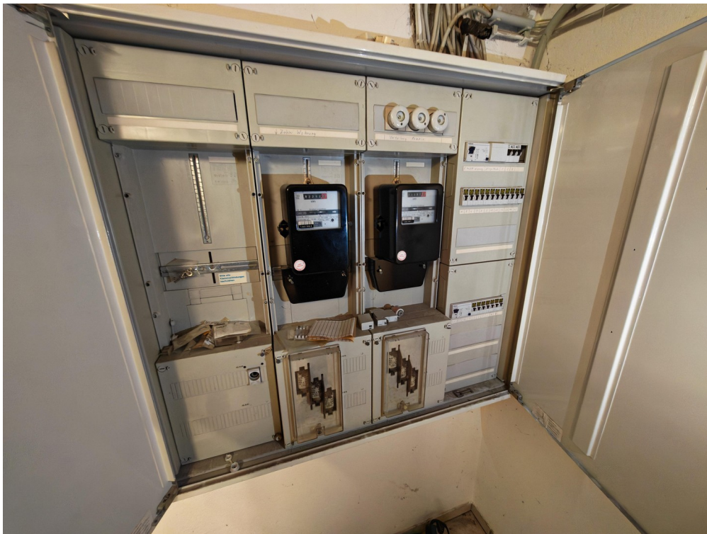
geteilte Elektrik inkl. FI
