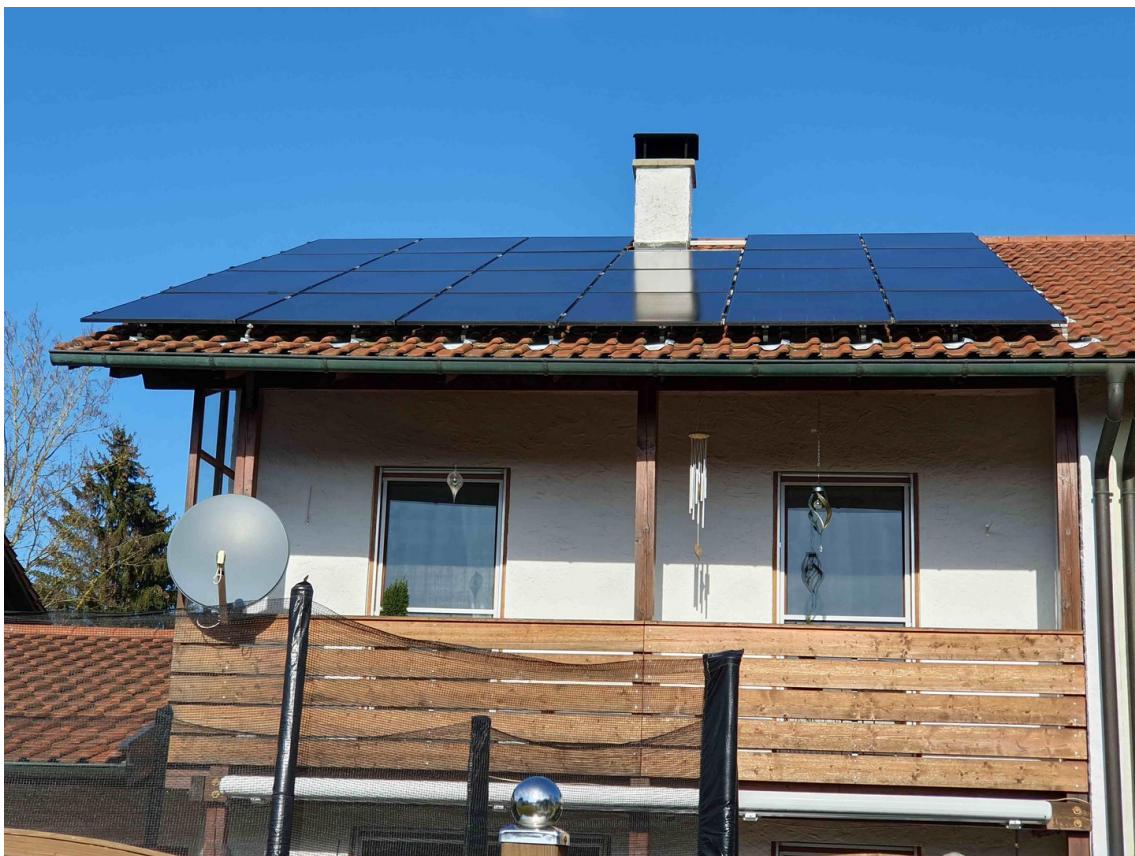
PV Anlage und Balkon
