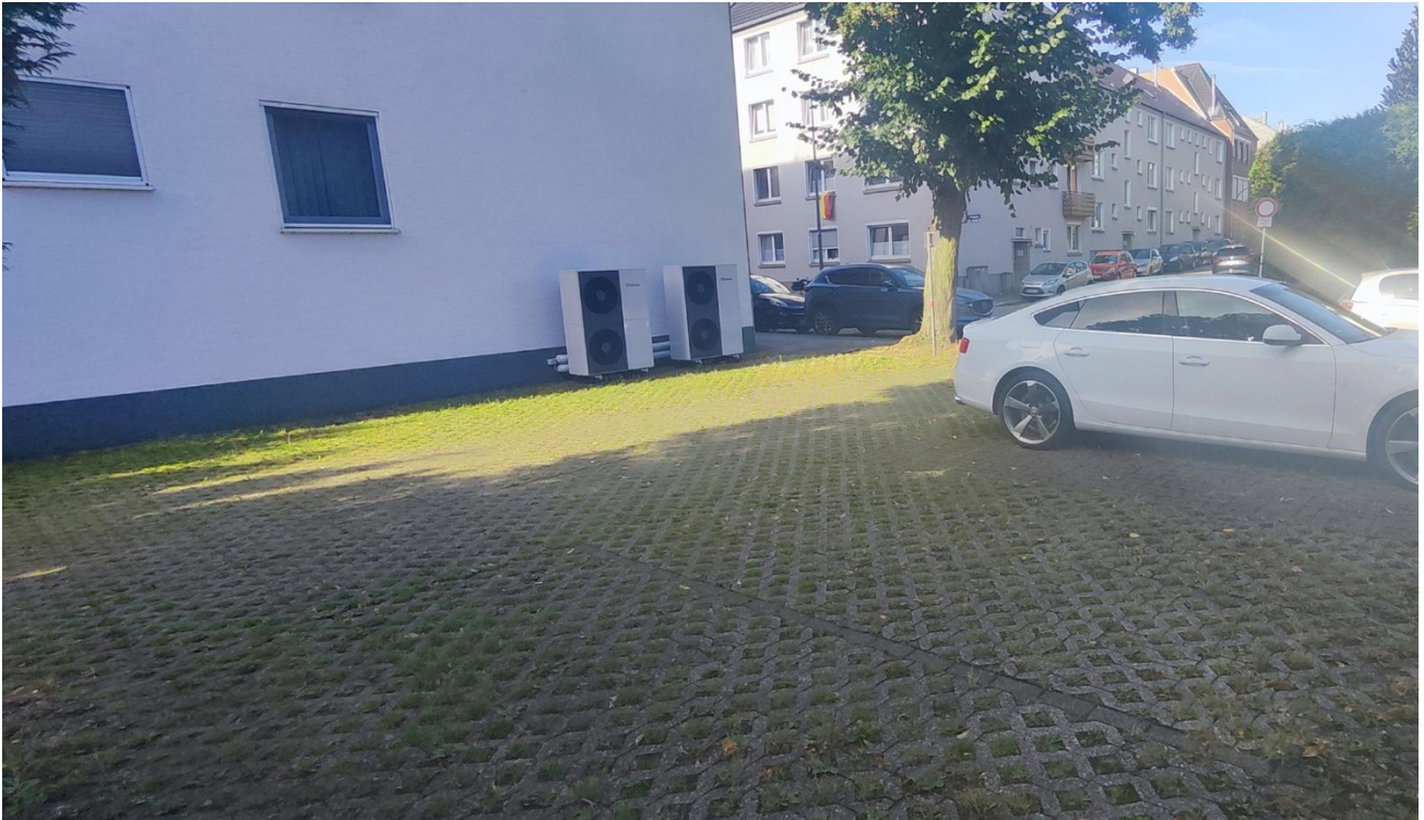
Stellplatz mit Wärmepumpen
