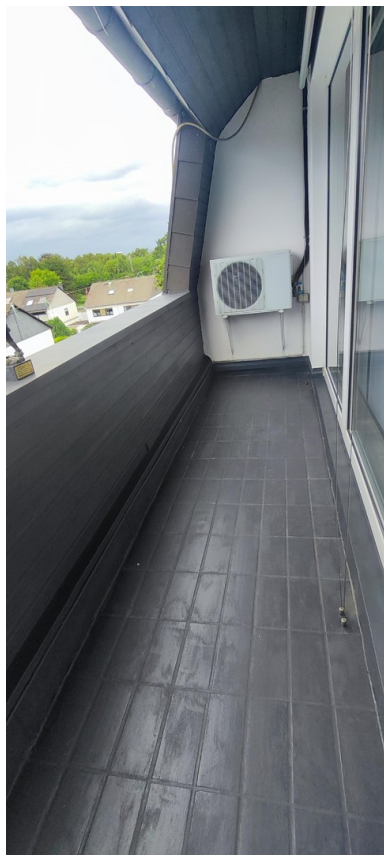
Klimasplit für Dachgeschoss
