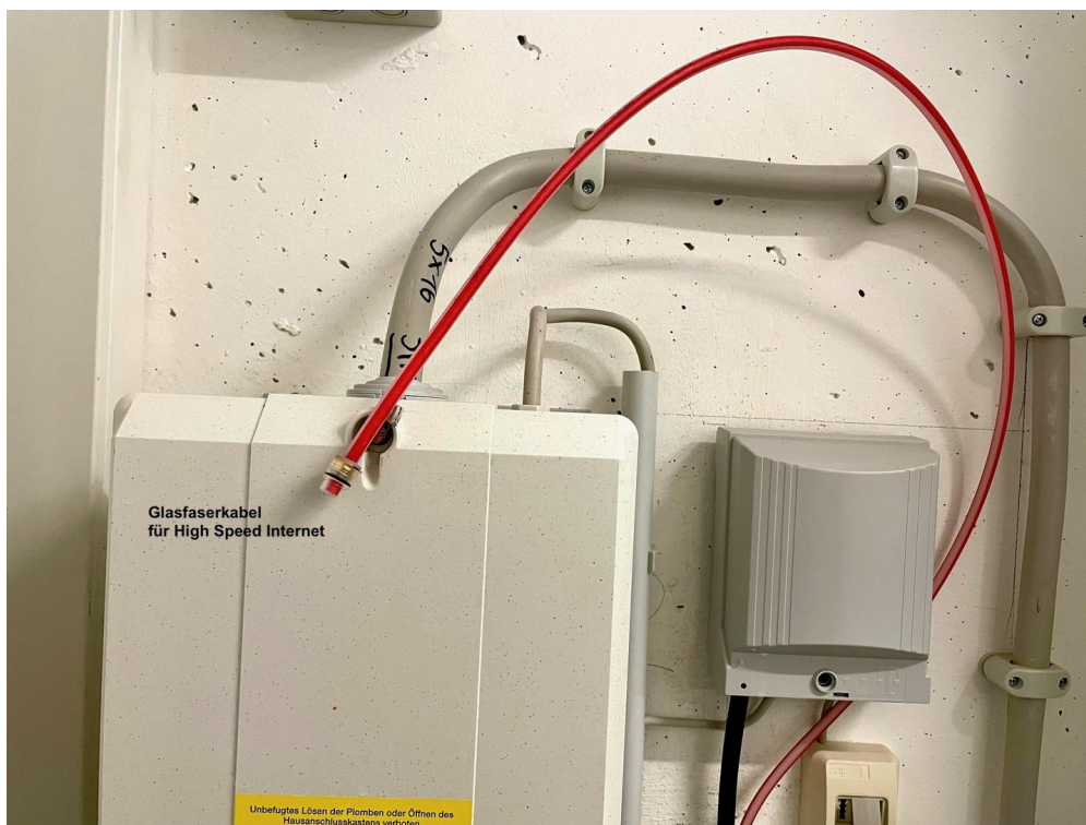
Glasfaserkabel für Highspeed
