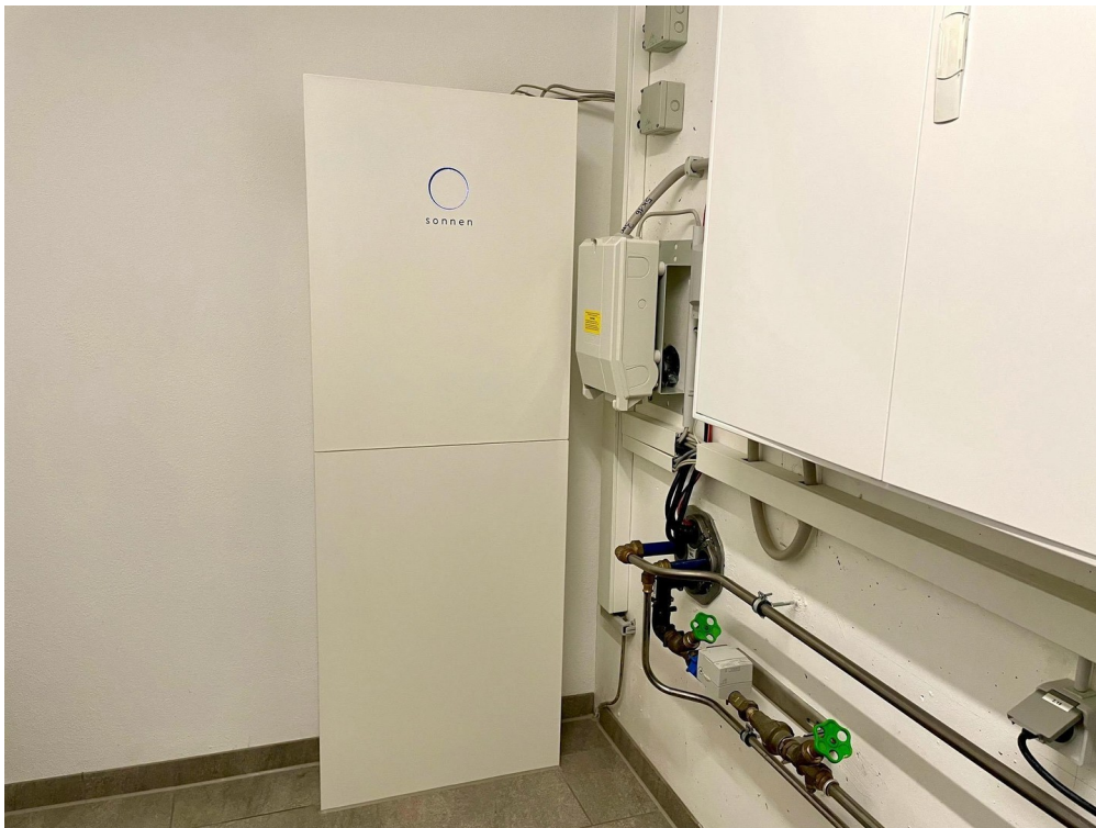
PV-Stromspeicher für PV-Anlage
