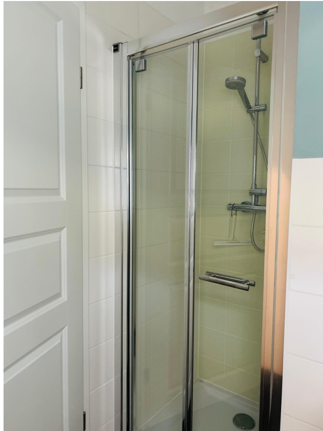
Dusche Gäste-WC EG
