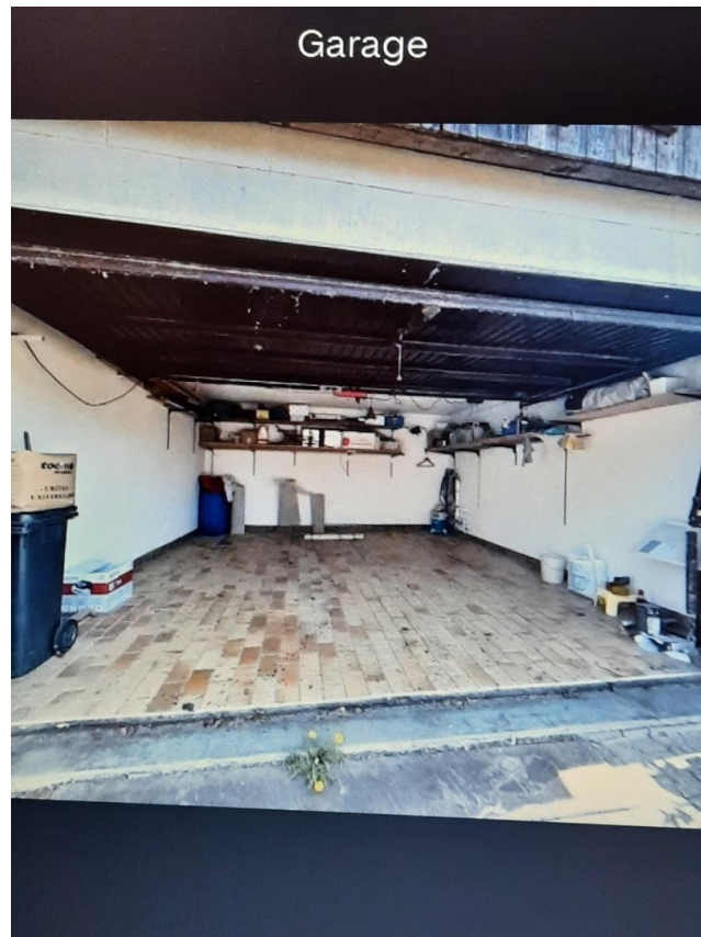
Doppelgarge mit Strom und Wass
