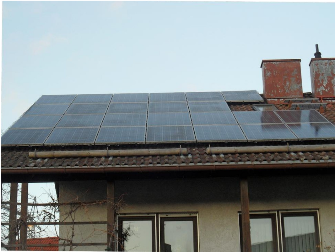
PV-Anlage ca. 23 qm, 5.3 kWp
