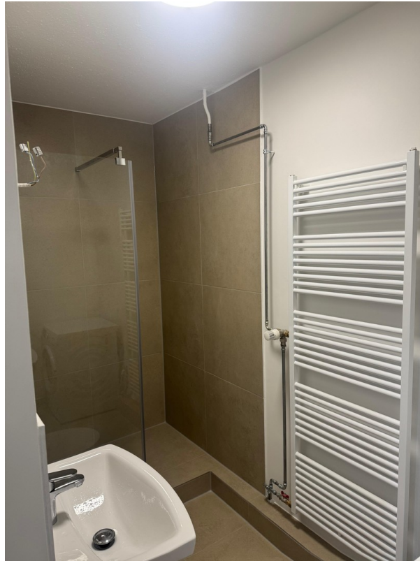
Dusche und Handtuchheizkörper
