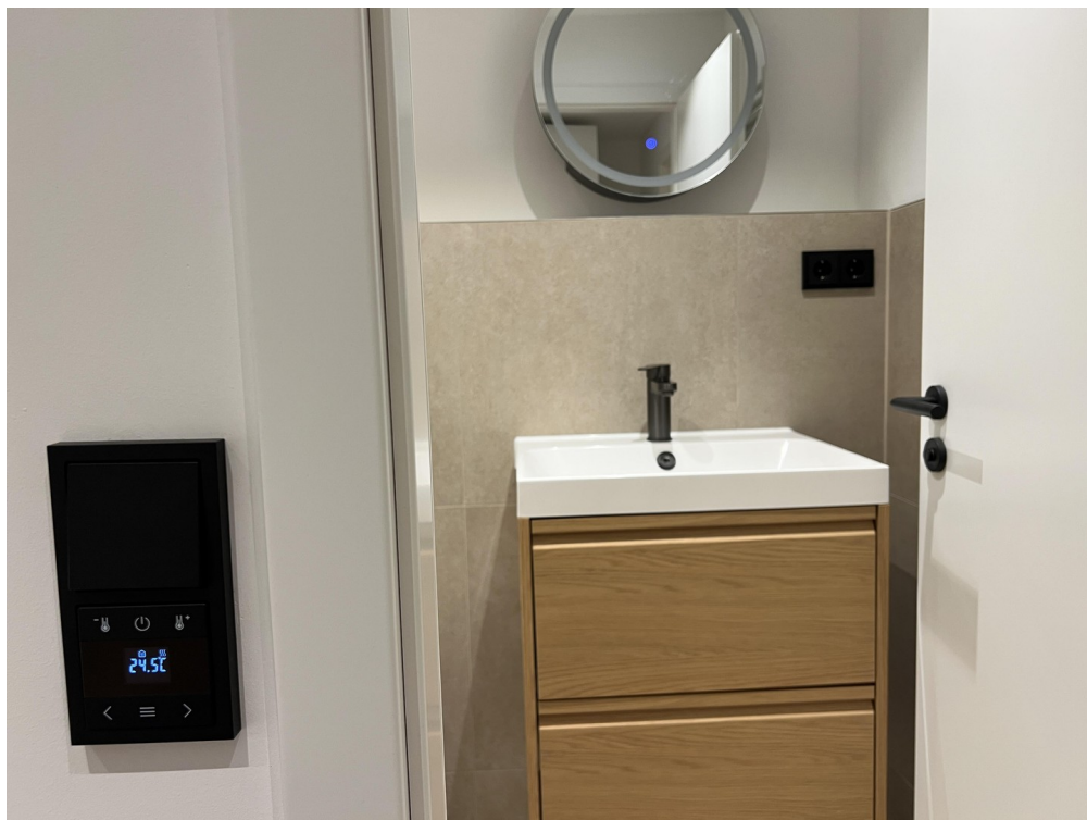
Fußbodenheizung im Bad
