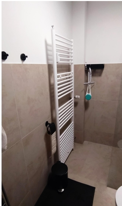
Bad - Heizung u Handtuchwärmer
