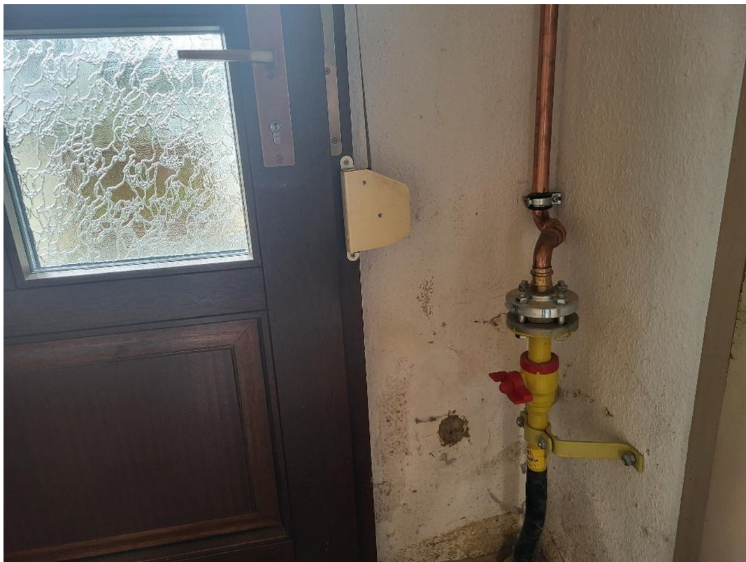
Eingangsbereich mit Gasanschl
