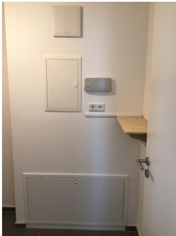
Datenverteiler, Router, HAR
