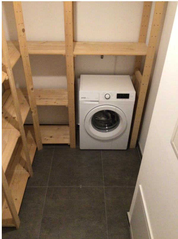
Integrierte WA im HAR
