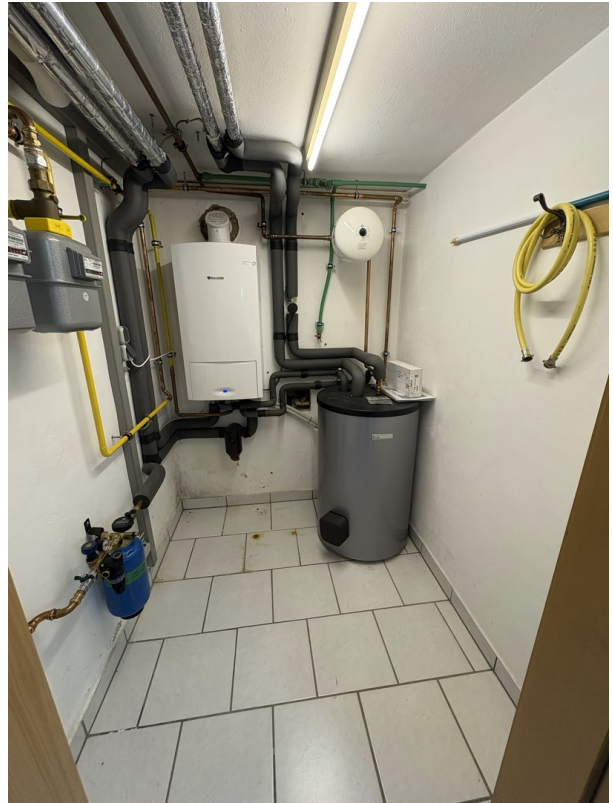
Heizung Wohnung EG
