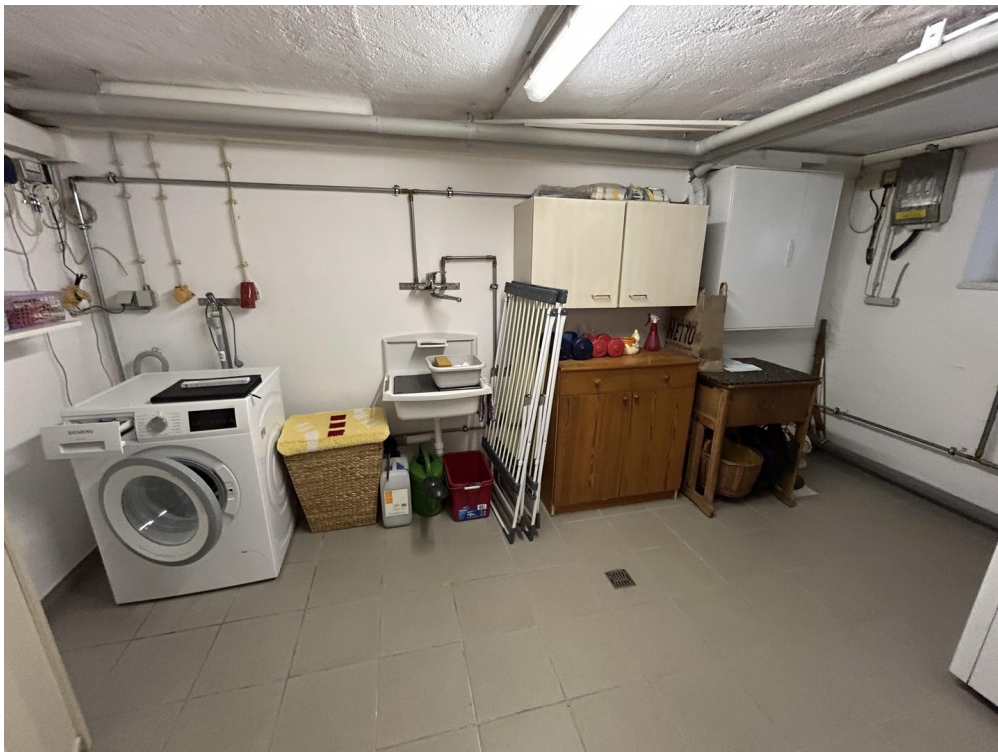
UG Wirtschaftsraum mit Heizung
