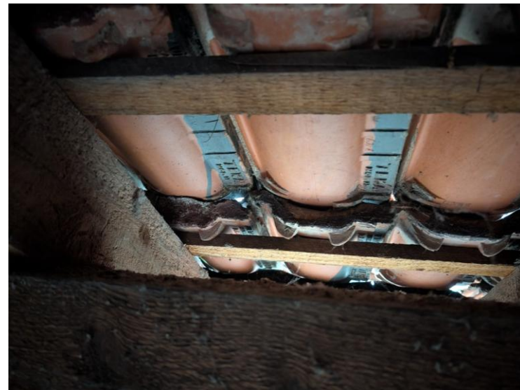
Foto B 16: Untersicht des Daches ohne Folie und Dämmung
