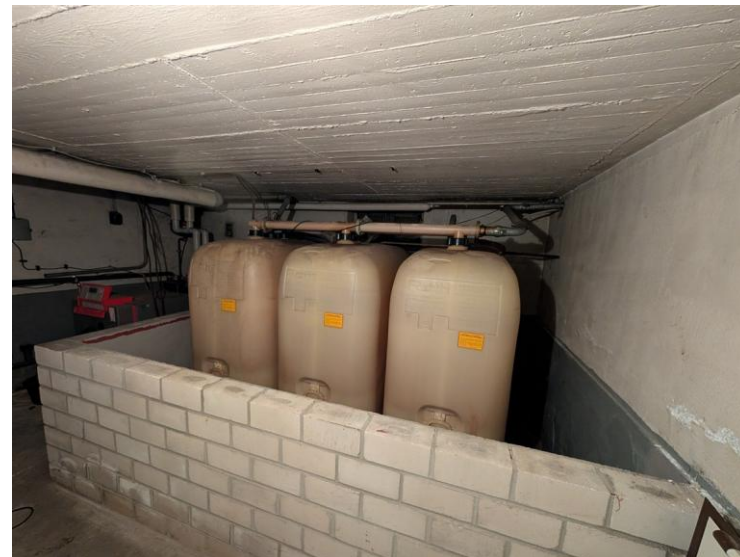
Foto B 4: KG-Öltanks
