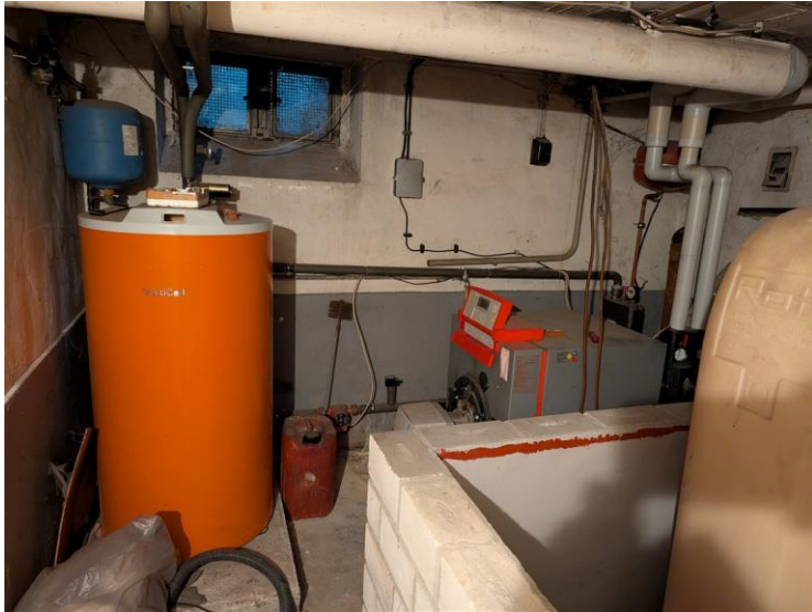
Foto B 5: KG-Ölheizung
