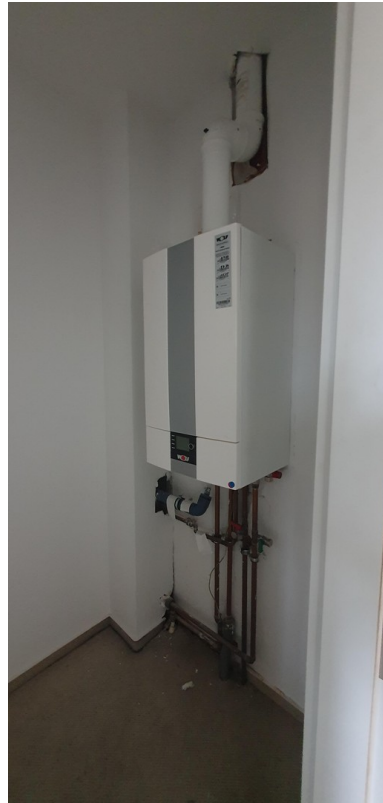
Heiztherme im OG / Kammer
