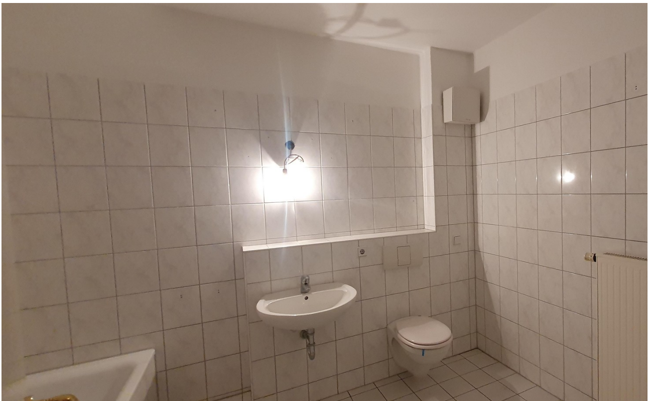
Bad OG Waschbecken WC
