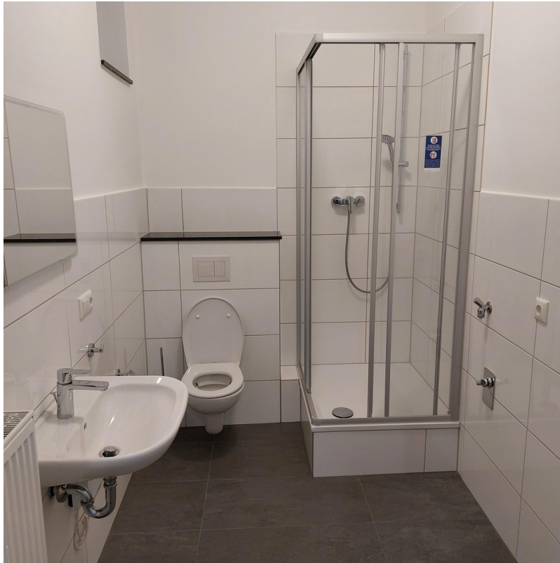
2. Duschbad mit WC
