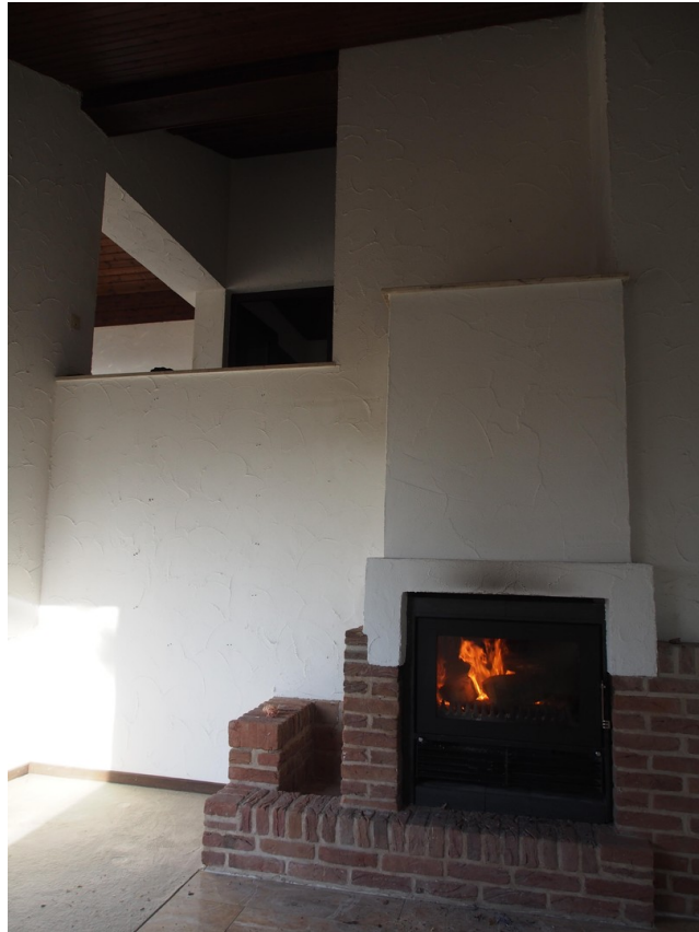
Holzofen im Wohnzimmer
