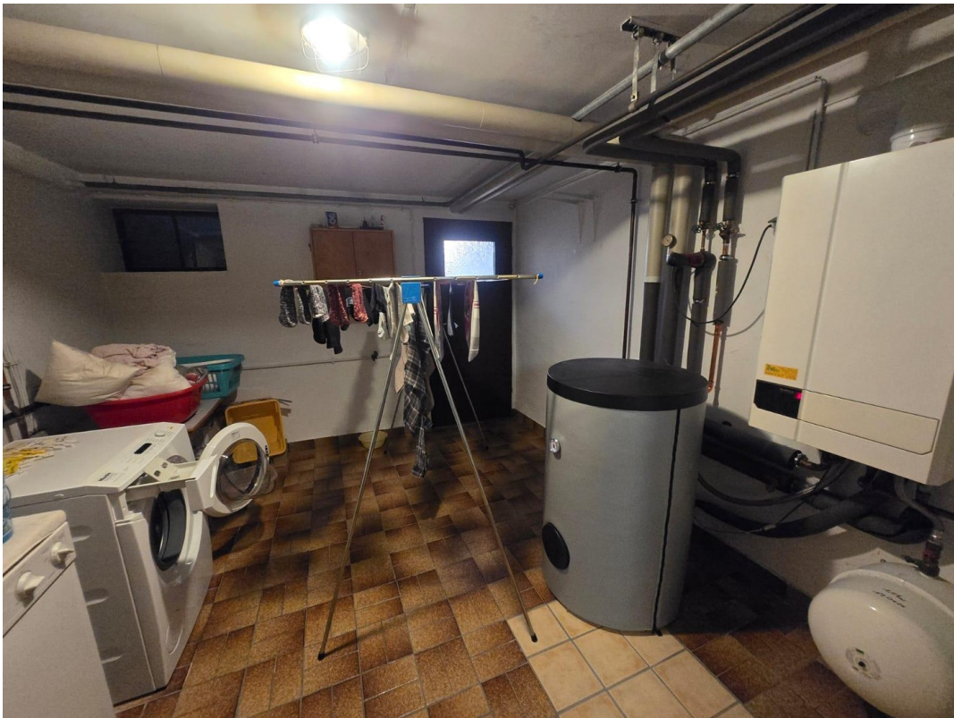
Heizung und Waschen
