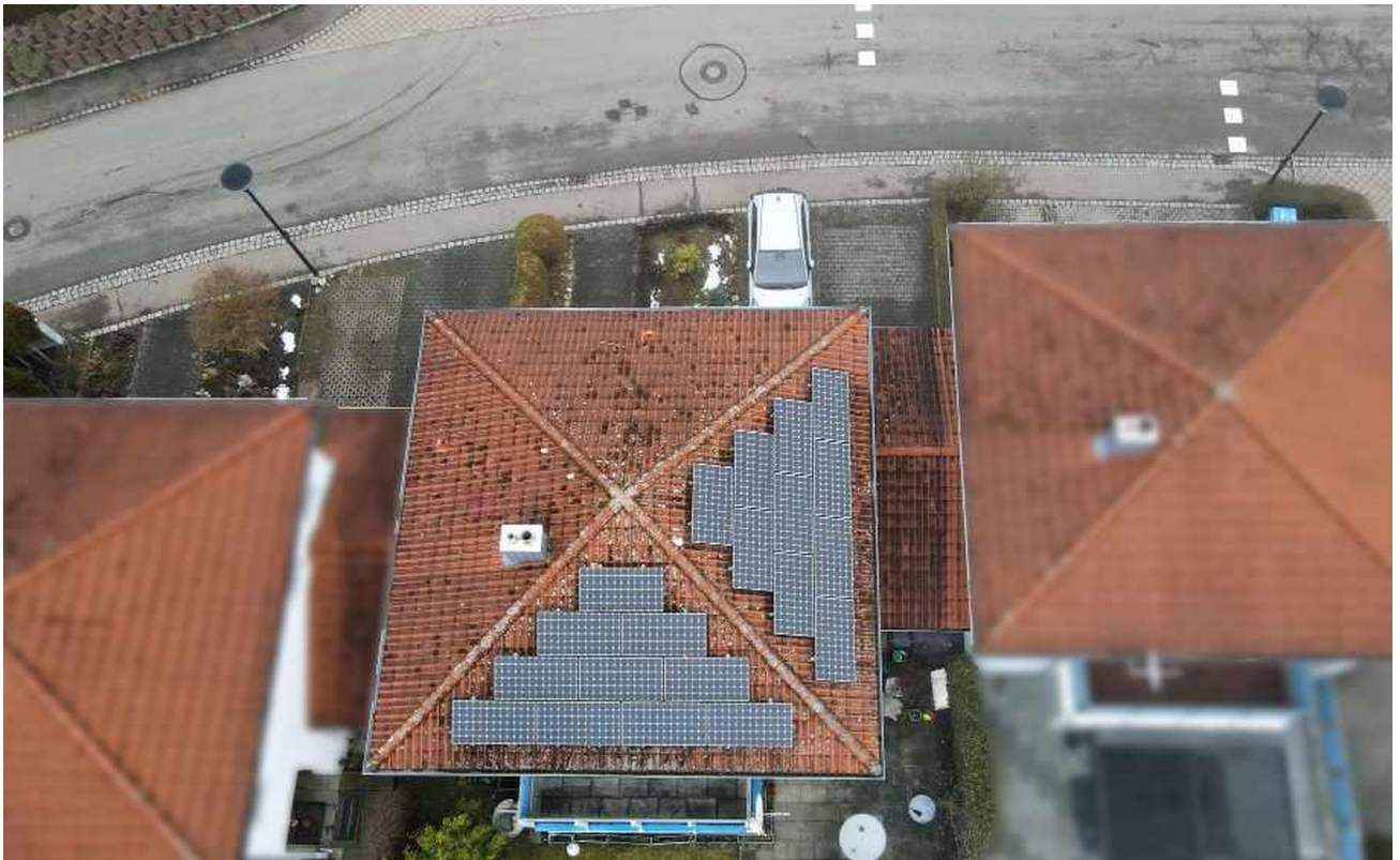
Dachaufsicht PV- Anlage
