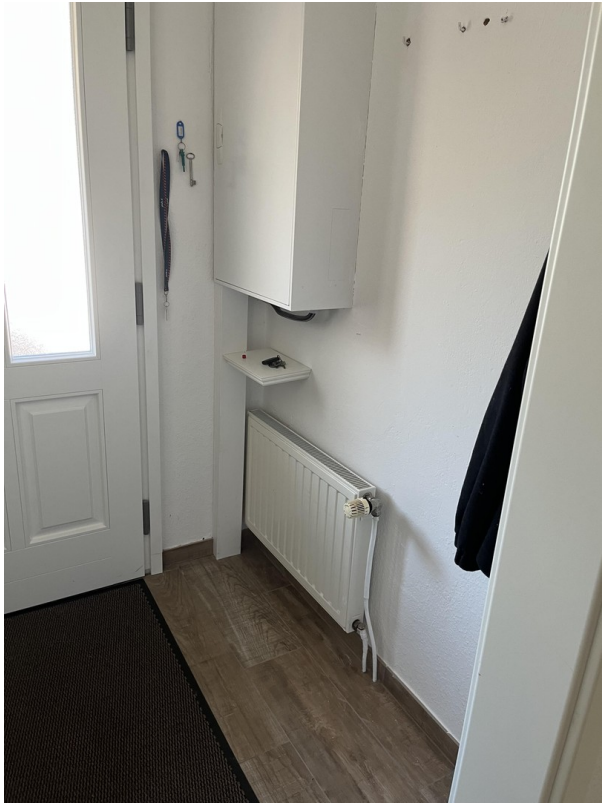
Eingang 2 mit Sicherungskasten
