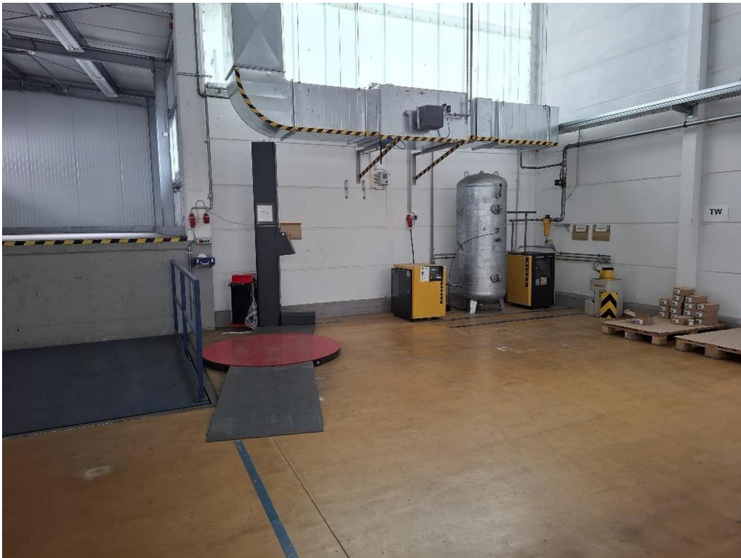
Kompressoranlage und Stretcher
