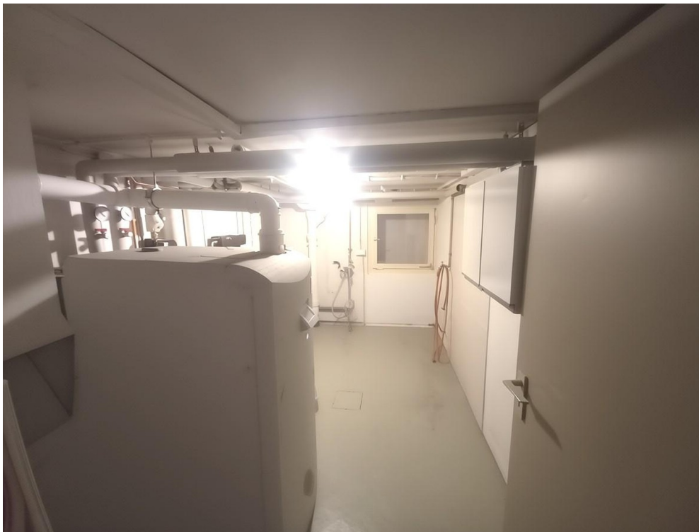
Wasch- und Heizungsraum
