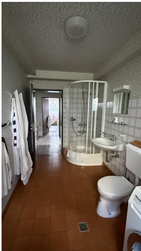
Waschküche Duschbad Souterrain
