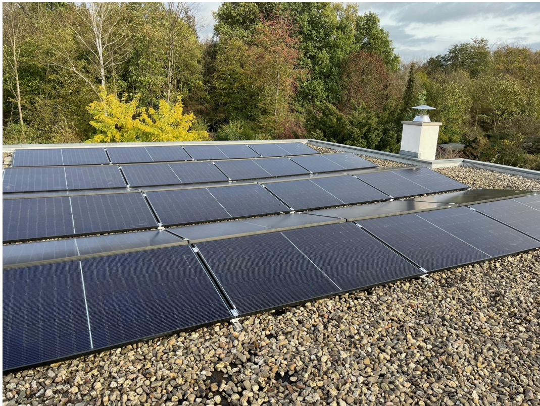
PV-Anlage auf Flachdach
