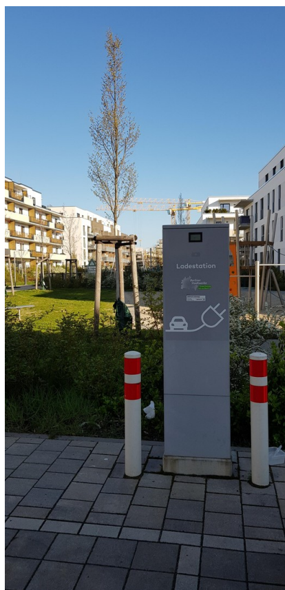
Zwei E-Ladesäulen im Quartier
