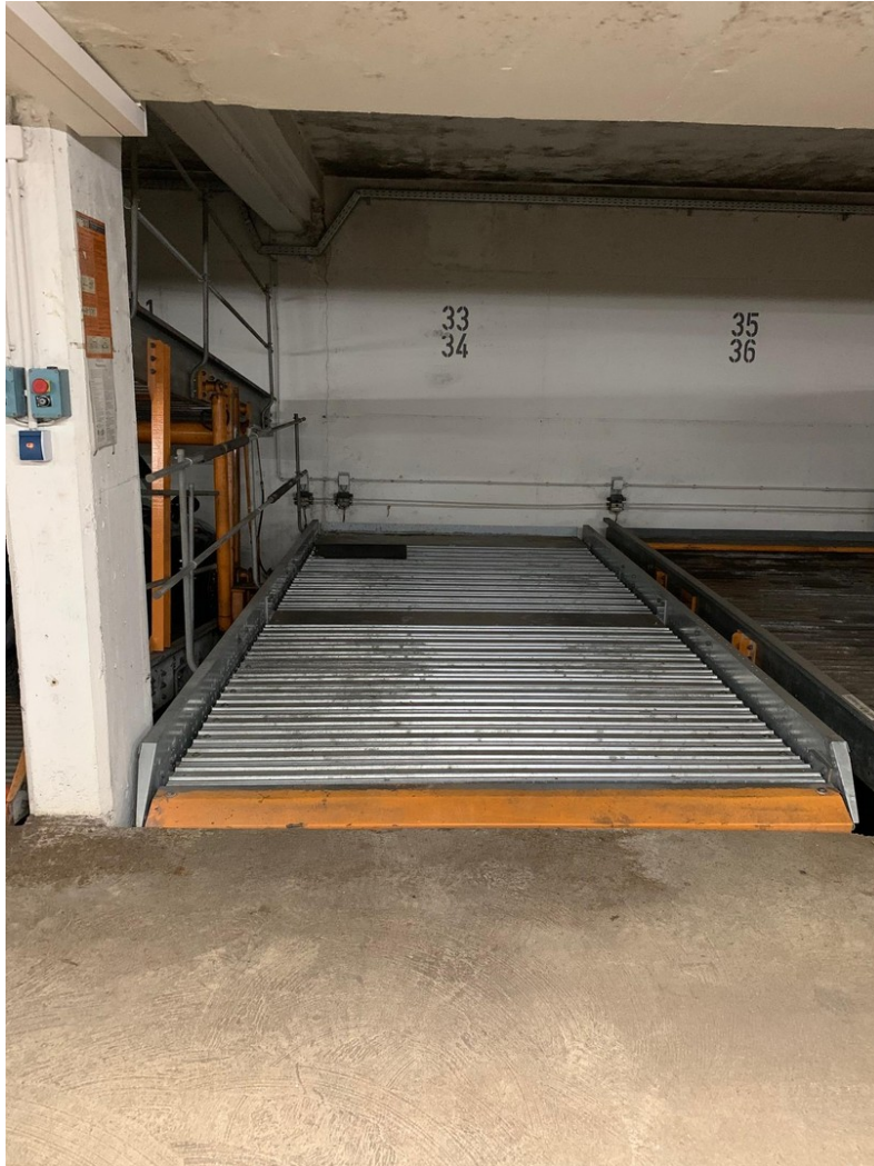
Duplex Parkplatz (oben)
